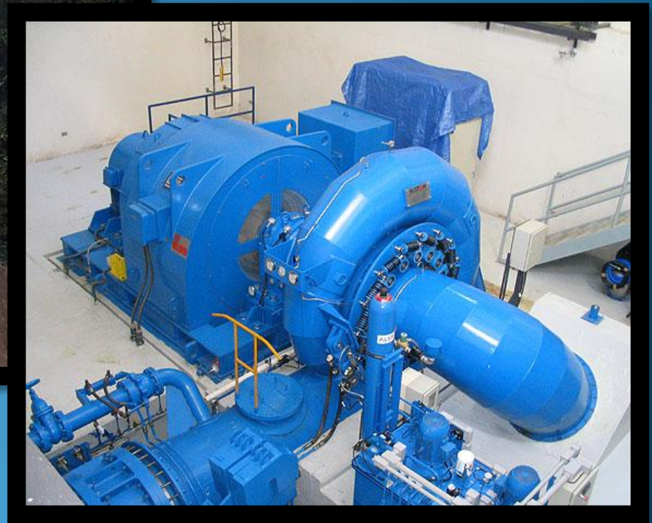
Turbina Alstom Planta Hidroeléctrica Río Blanco.
