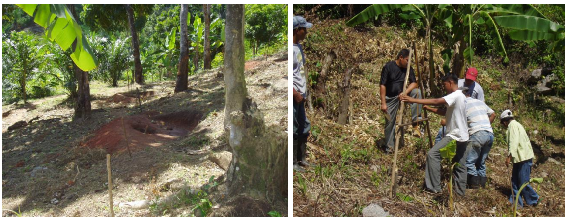
Infraestructura para el desarrollo de labranza mínima de parcelas en curvas de nivel
